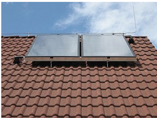
2 kolektory v zostave TS 300 – maximálna výška dotácie je 1233,-Eur.
