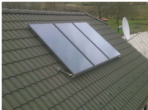
3 kolektory v zostave TS 300 – maximálna výška dotácie je 1750,-Eur.
