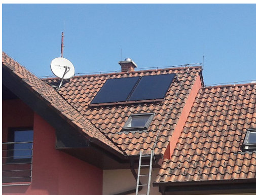
2 kolektory v zostave TS 500 – maximálna výška dotácie je 1563,-Eur.
