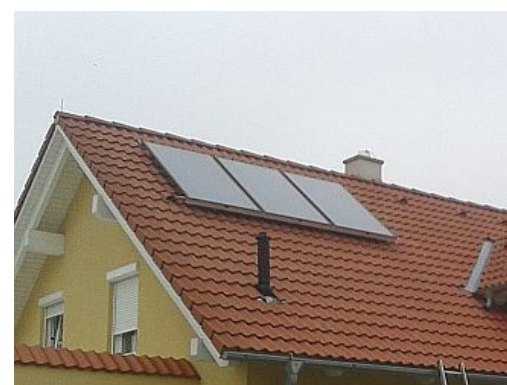
3 kolektory v zostave TS 500 – maximálna výška dotácie je 1750,-Eur.
