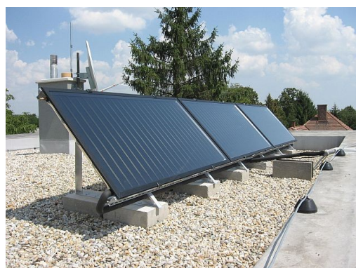
3 kolektory v zostave TS 330 – maximálna výška dotácie je 1750,-Eur.
