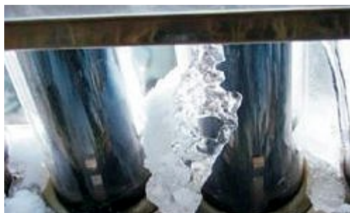
Ead – veľký nepriateľ vákuových rúr. Roztopenie a opätovné zamrznutie snehu medzi rúrami je spojené s objemovými zmenami, ktoré môžu viesť k deštrukcii rúr
